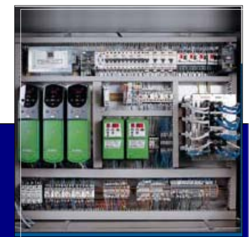
Cuadro eléctrico con control por PC Industrial Electrical Cabinet with Industrial PC Control Panneau électrique avec contrôle par PC industriel
