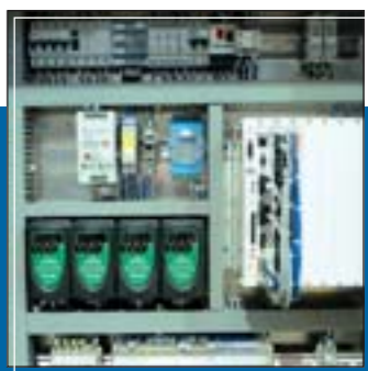
Cuadro eléctrico con PC industrial Electrical panel with industrial PC Panneau électrique avec PC industriel
